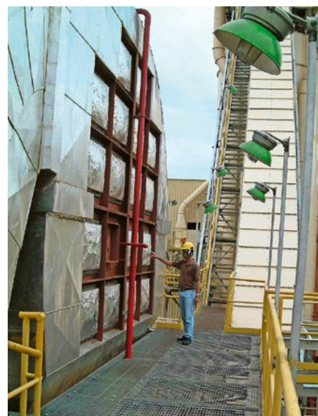
Panneaux d'événements d'explosion dirigés vers une zone de passage de personnes.
