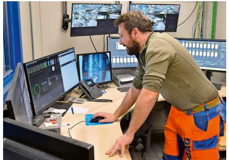
Die Steuerzentrale des Betonwerks.
