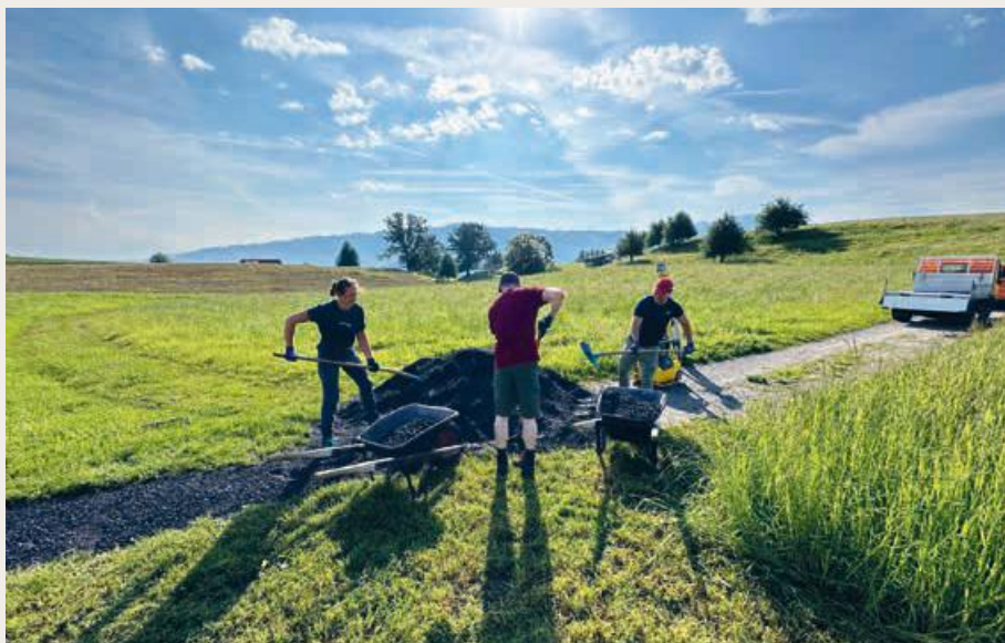
Des collaboratrices et collaborateurs de la Mobilière restaurent un chemin de randonnée à Risch-Rotkreuz.
